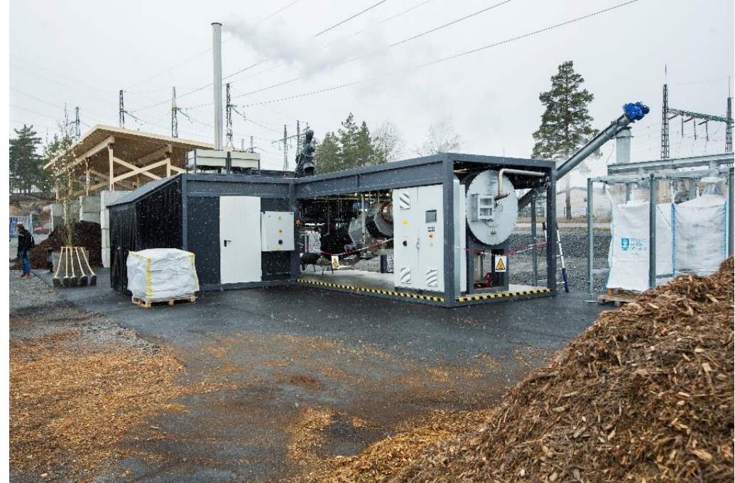
Biokolanläggning i Högdalen.
